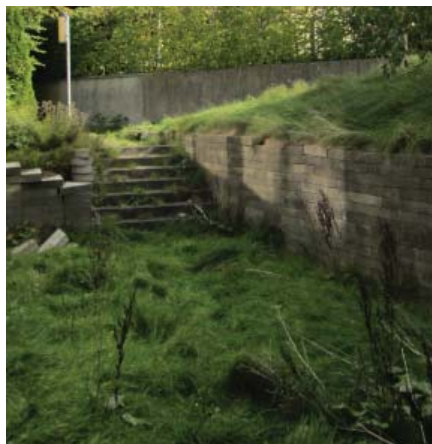
'Beplantningen har ikke været vedligeholdt i den periode, hvor ejendommene har stået ▼ tomme, og fremstår vildtvoksende. ►
