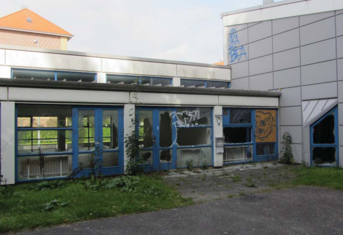
▲ Dele af den eksisterende bygningsmasse har været udsat for hærværk og ildspåsettelse. Det skæmmer bybilledet, og sender et dårligt signal til naboer og de forbipasserende på Østre Alle.
